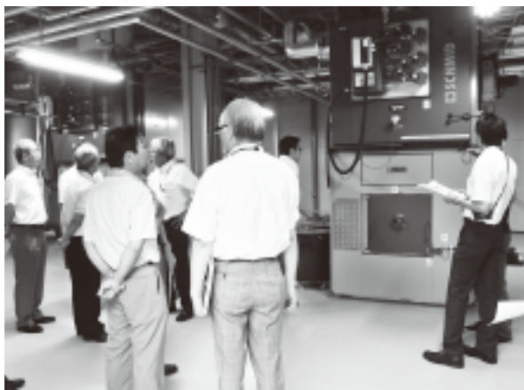
一の橋の木質ボイラー施設を視察する人たち(9月中旬)。発電よりも熱利用のデータ集めが先だ
