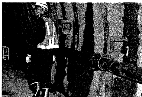
幌延深地層研究センターの試験坑道。地下水の湧出であちこち、コンクリート壁面が黒くじむ(2010年11月)
