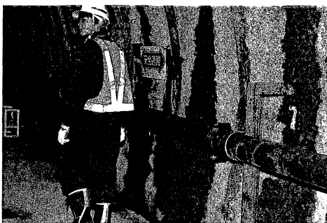
幌延深地層研究センターの試験坑道。地下水の湧出であちこち、コンクリート壁面が黒くにじむ(2010年11月)
