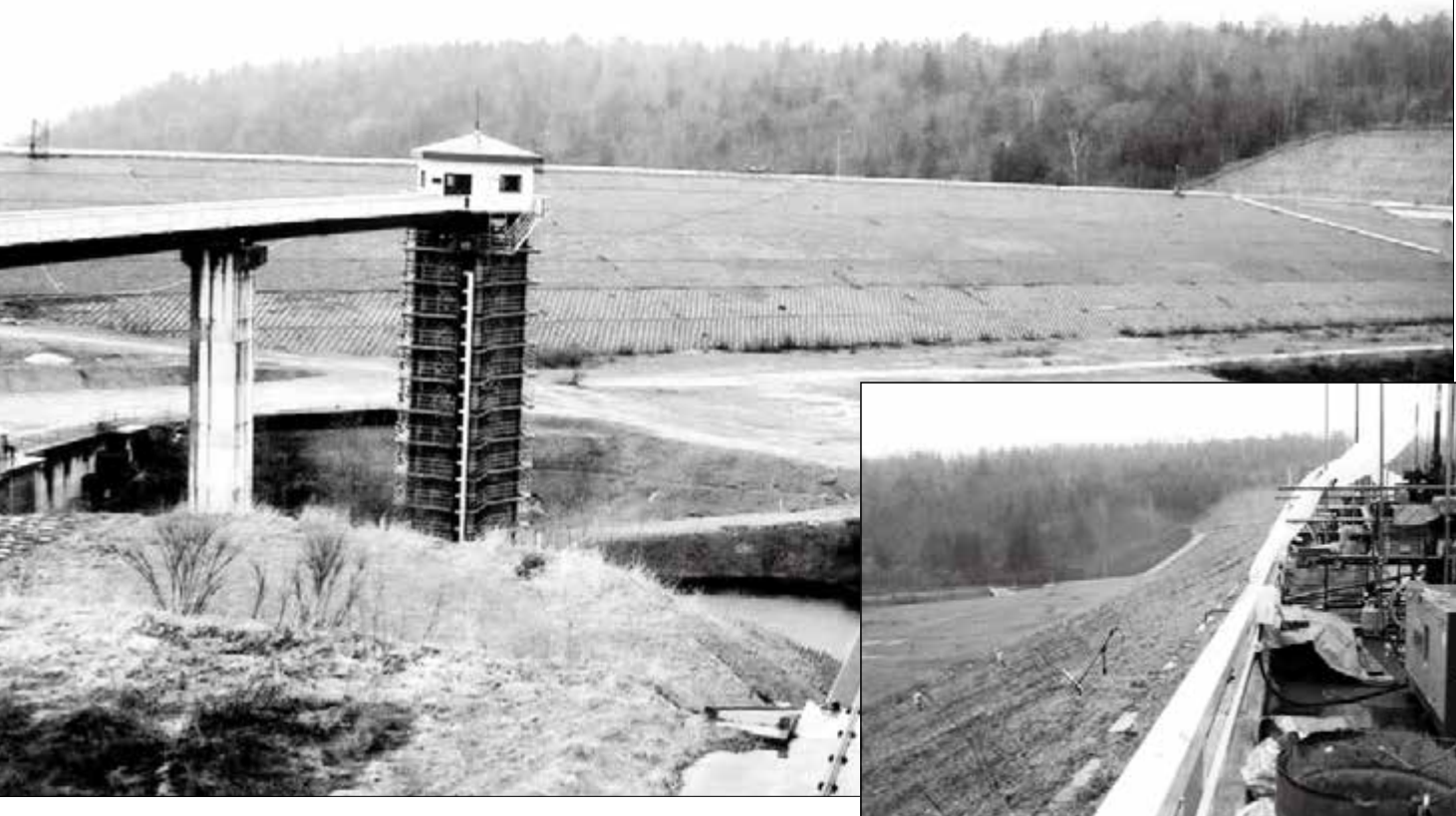
本体の完成から20年あまりの歳月が流れたが、漏水のためダム湖に水を貯められない東郷ダム。写真は13年前のものだが、現在も状況は変わらない。堤体とその周辺でボーリング調査や地盤改良などが行なわれた(写真右下)。ダムの総事業費は約200億円、このうちの半分ほどが試験湛水の中止後に支出された
