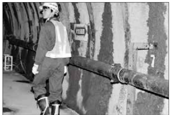
幌延深地層研究センターの調査坑道(地下140m)。日量100t以上の地下水が湧出し、吹きつけたコンクリートからにじみ出ている(黒く見える部分)
