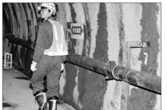
幌延深地層研究センターの調査坑道(地下140m)。日量100t以上の地下水が湧出し、吹きつけたコンクリートからにじみ出ている(黒く見える部分)
