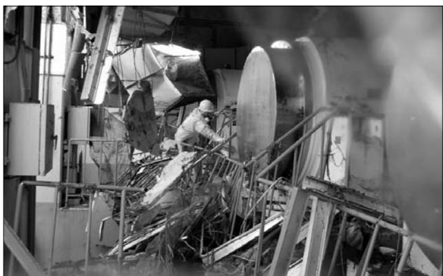
福島第1原発の事故直後の使用済み核燃料乾式貯蔵施設。津波が押し寄せたが、中身は無傷だった(東京電力撮影)
